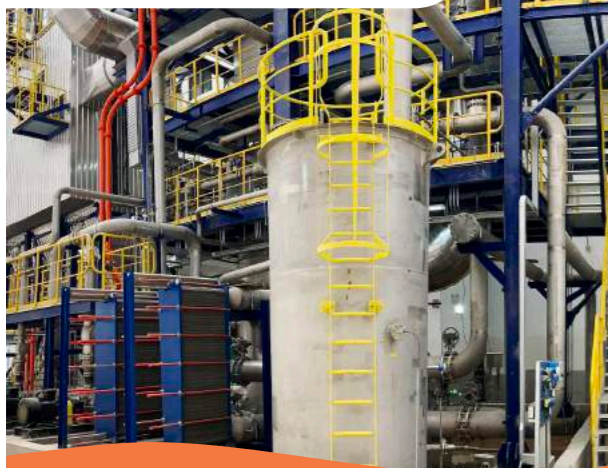
上海浦东污泥处理处置工程 Shanghai Pudong sludge treatment and disposal project
