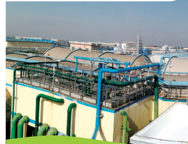
上海化工园区污水处理项目
